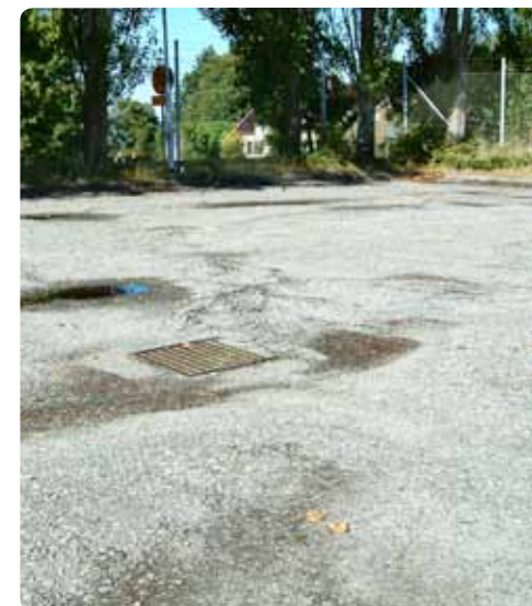
Det blir ofta sättningar runt rännstensbrunnar.
